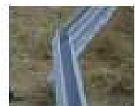
Кабельный канал с пролетом в 6м
